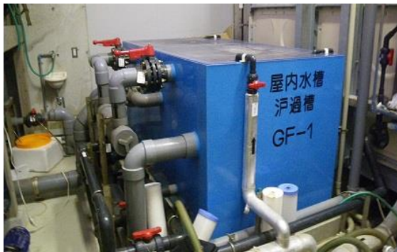
図 1 自然館の屋内水槽 濾過槽
